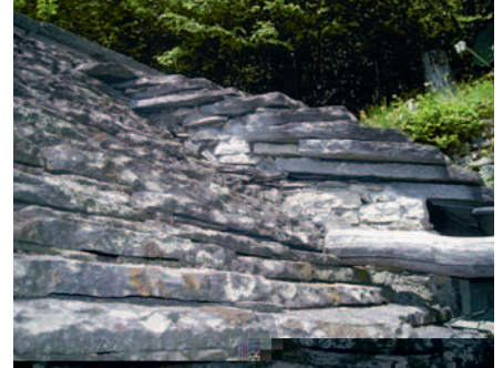
Das Pendant: Granitdach aus beschlagenen und geschnittenen Granitplatten – teuer im Bau, dafür dicht und praktisch unterhaltsfrei.
